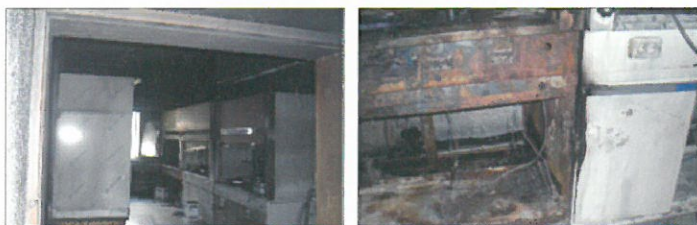
그림 6-2 전기 설비 과열에 의한 실험실 화재
