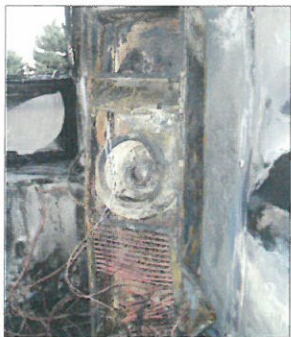
그림 6-1 실험실 에어컨의 전선 또는 멀티콘센트 케이블 과열
